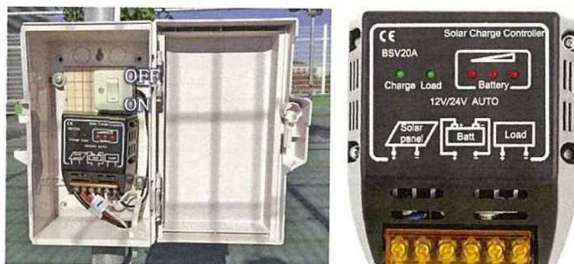
図 6.2.2 防水 BOX5 内のソーラーコントローラ
