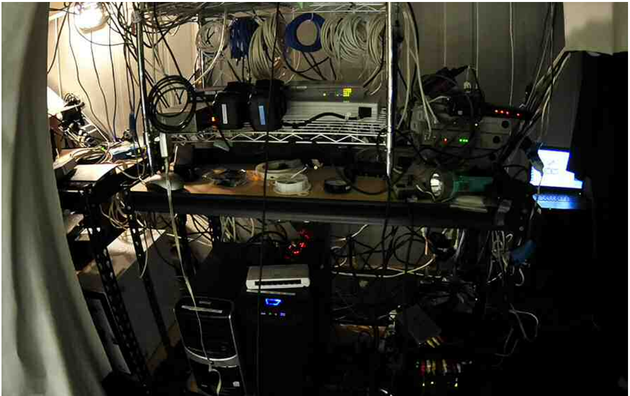
観測所内コンピュータールーム
