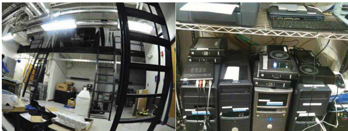
アラスカ観測所 / 三鷹内設備
